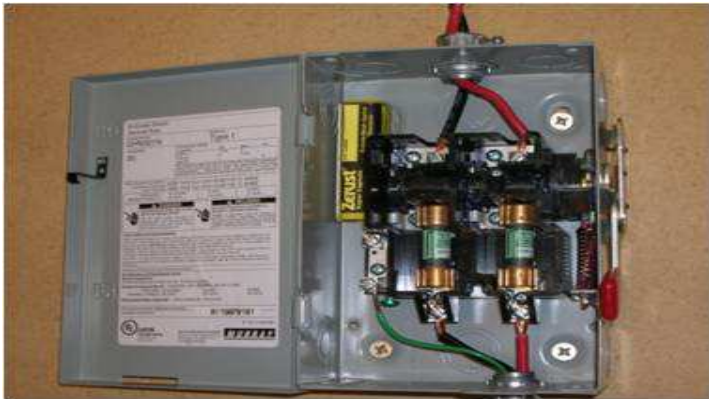
Protección Cajas De Fusibles
